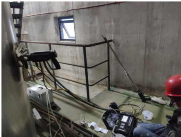
1#排气筒 DA001（◎1）有组织排放废气
